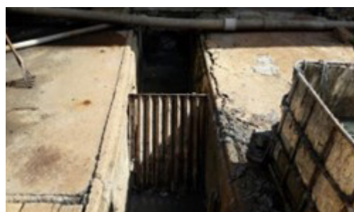
Figura 13 - Gradeamento para retenção de sólidos grosseiros.
