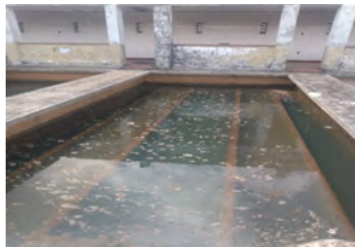
Figura 3. Filtro da ETA 5º Setor
