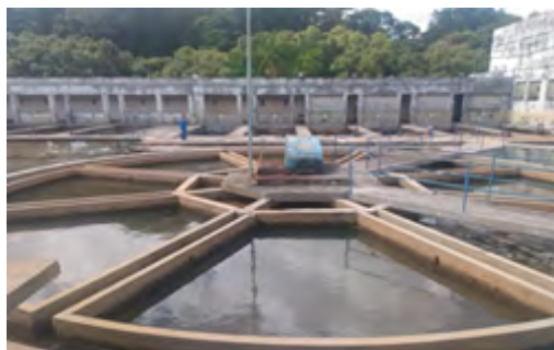
Figura 4. Filtro da ETA 5º Setor
