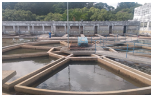
Figura 4. Filtro da ETA 5º Setor
