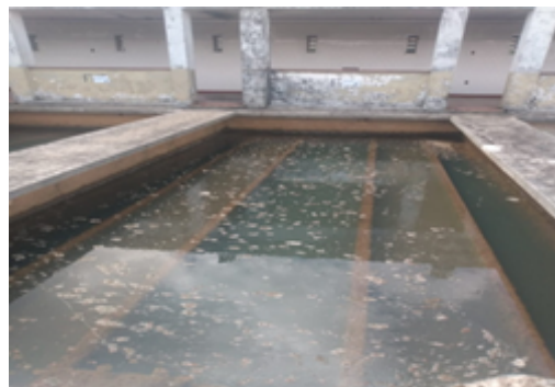
Figura 3. Filtro da ETA 5º Setor
