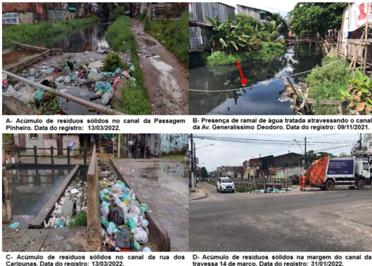
Figura 4. Canais de macrodrenagem.
