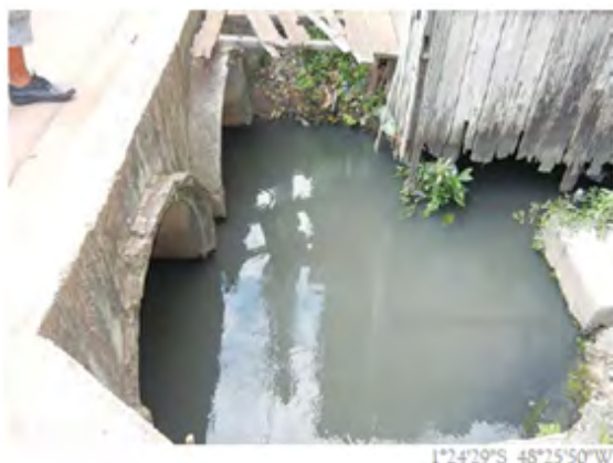
Figura 10. Lançamento de esgoto na cabeceira do lago Bolonha, no Parque Estadual. Fonte: PARÁ, 2013.
