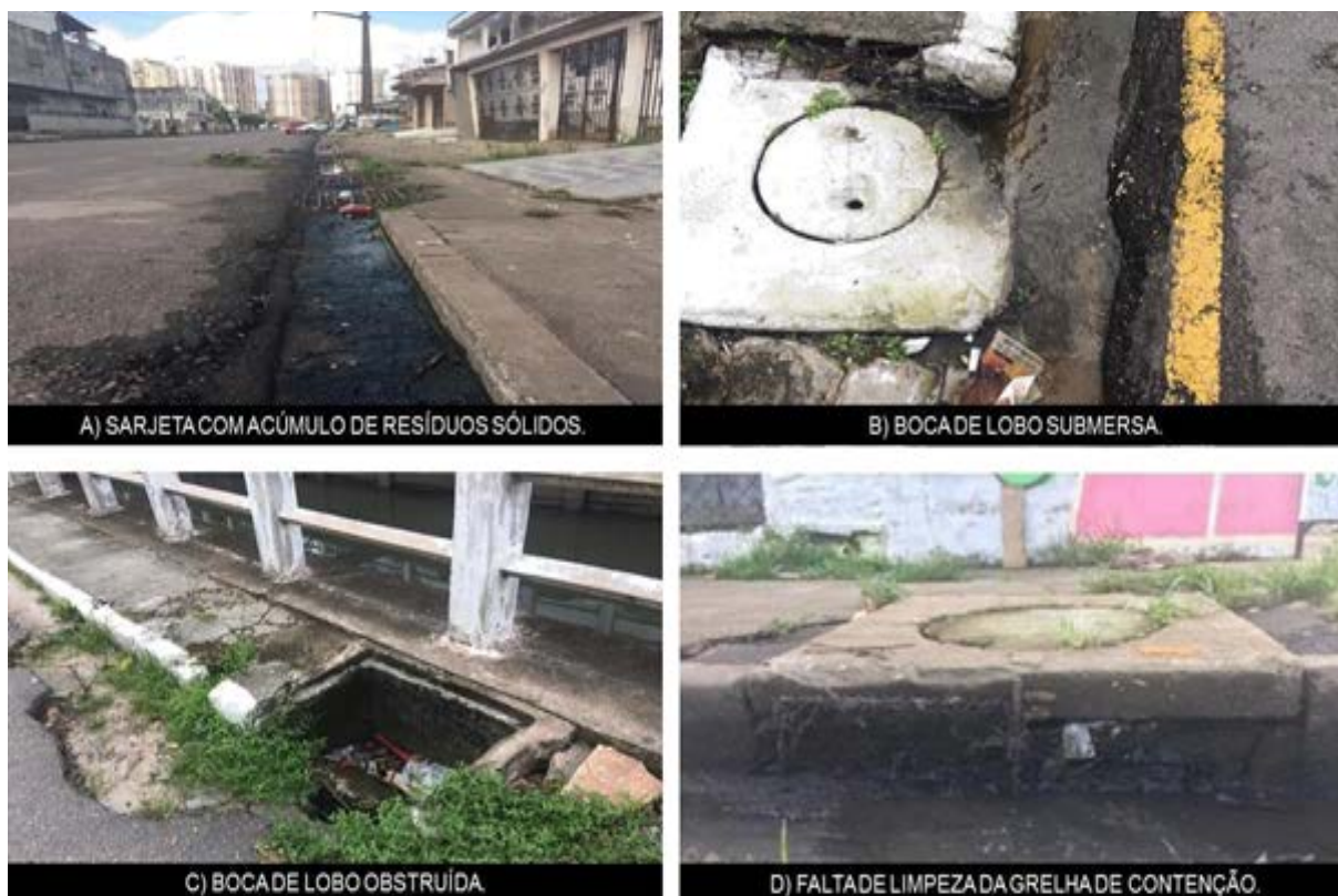
Figura 4. Dispositivos de drenagem superficial.
