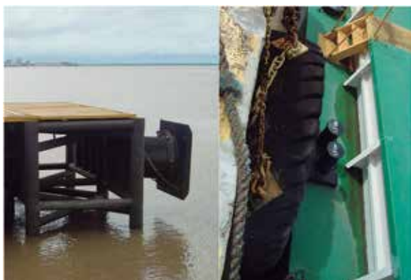
Figura 03. Defensas tambor e hidropneumática.
