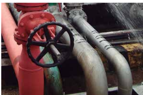
Figura 06. Identificação das tubulações.
