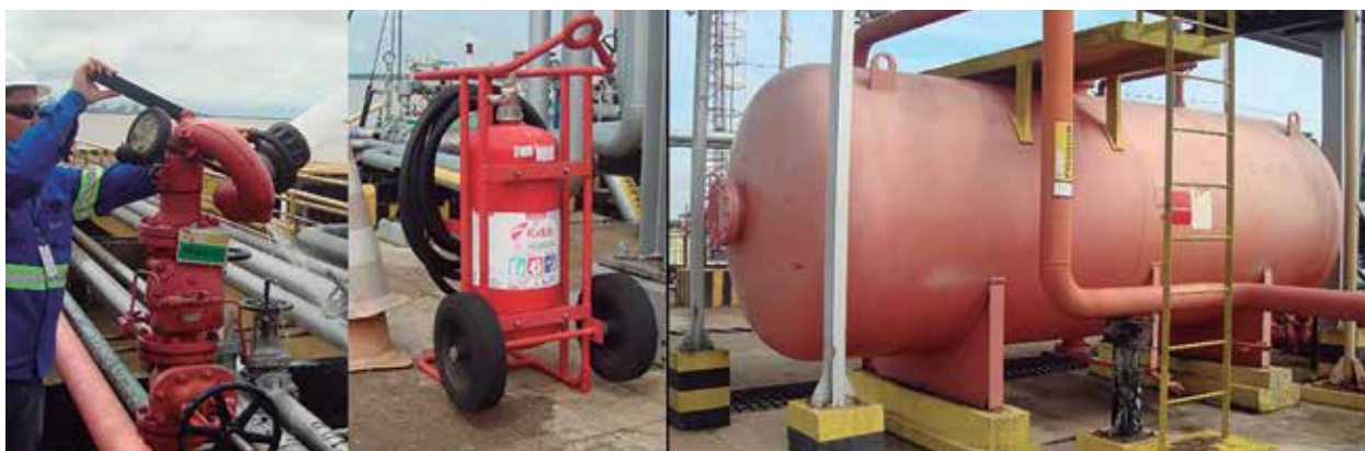
Figura 07. Combate a incêndio.
