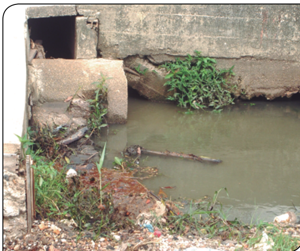
Figura 9. Esgoto a céu aberto na rua Dr. Miguel de Santa Brígida (bairro Atlântico II). Fonte: CRUZ, 2010.
