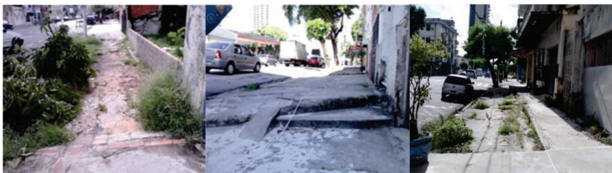
Figura 2 – Condições de calçadas no Bairro do Umarizal – Belém/PA.
