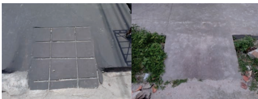
Figura 5 – Rampas encontradas nos trechos.
