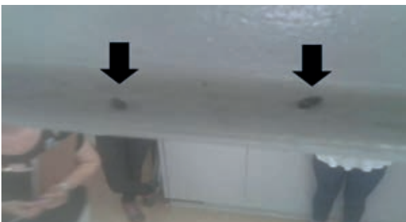
Figura 14. Fezes no telhado da sala dos professores.
