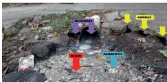
Figura 6. Esgoto a céu aberto na Tv. Mariz e Barros.
