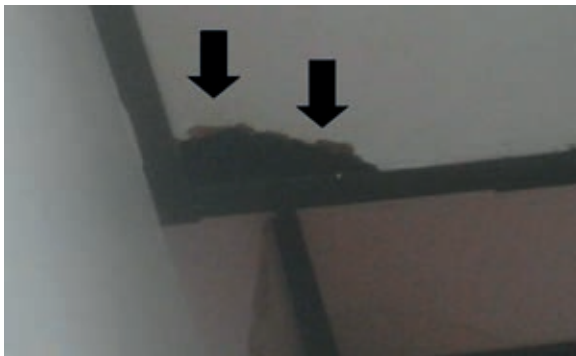
Figura 13. Sinais de roeduras na biblioteca.
